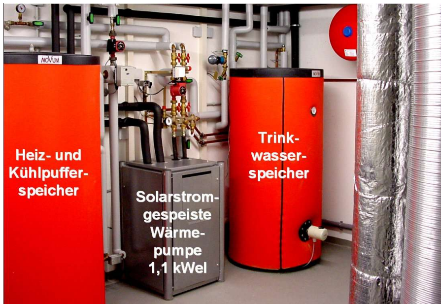
Bild 9: Solarstromgespeiste Sole-Wasser-Wärmepumpe Vitocal 300 BW
